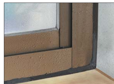
因鋁窗結露而造成潮濕的窗框與壁面
